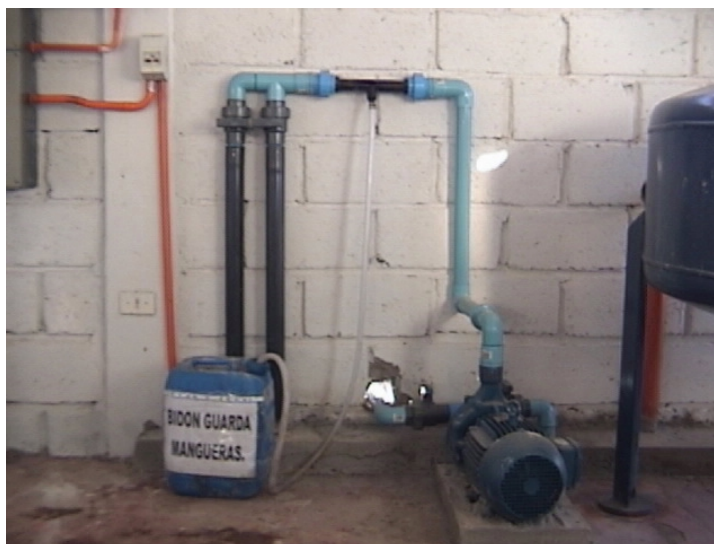
Foto 1. Equipo de inyección de Ac. Sulfúrico puro al sistema de riego
